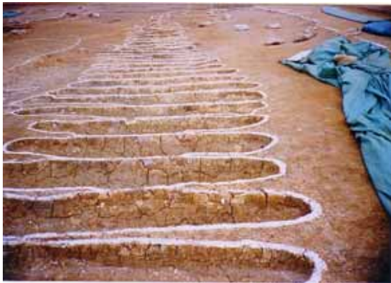
(道路面に材木を埋めて泥濘の防止をした跡)
